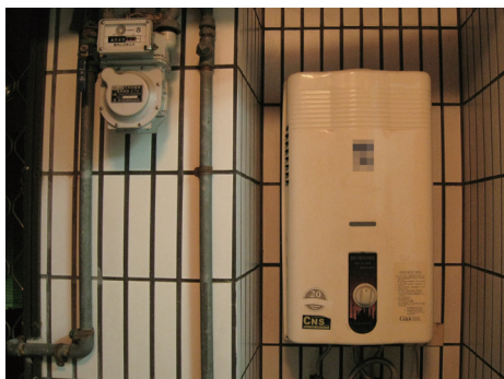
熱水器請裝設在通風良好的地方。
